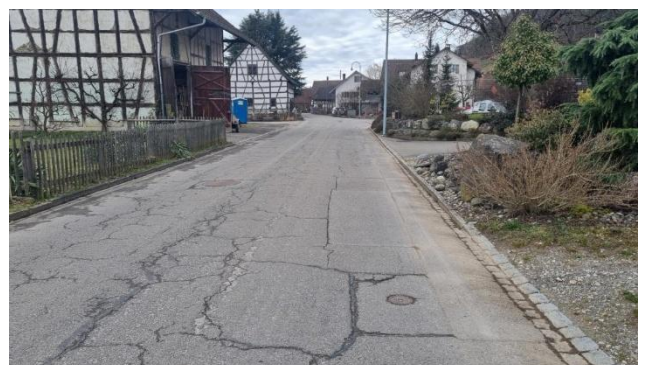
Abbildung 15: Wilde Risse, Belagsflicke
