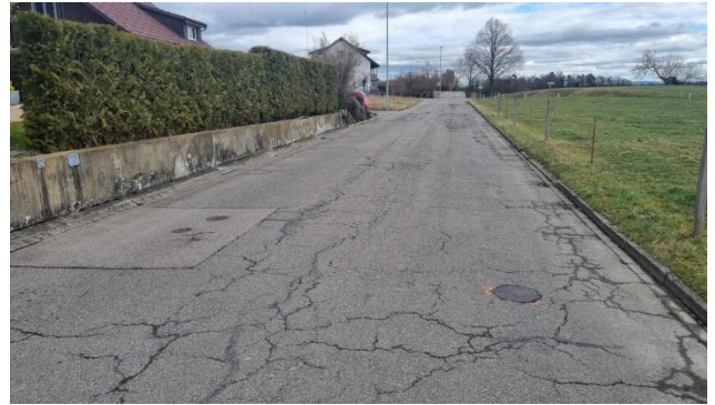
Abbildung 11: Wilde Risse, Belagsflick
